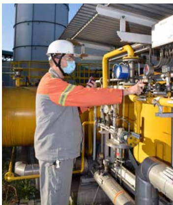
Sven Sczyslo bei der Überprüfung einer Anlage im Rahmen der Arbeitssicherheit
