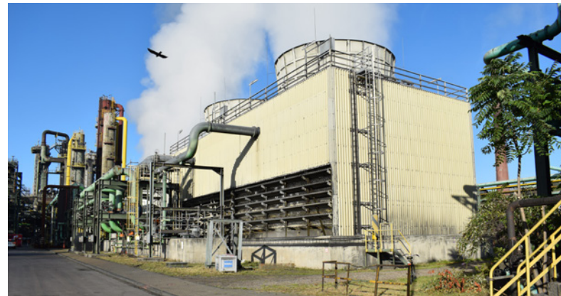
Blick auf Ventilatorenkühlturm vier
